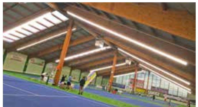
Die neuen LED-Langfeldleuchten der Tennishalle Naturns.
